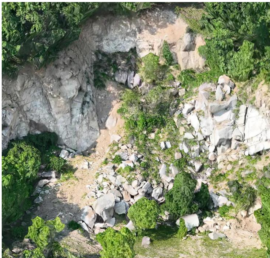
照片3-1 崩塌体现状
